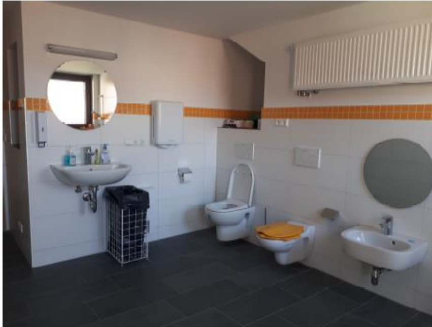
Sanitärinstallation in der Krippengruppe
